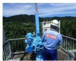
施設毎に機側操作盤により操作
