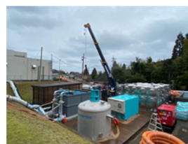
▲浄水場での活用(珠州市) 施設Ⅱ
