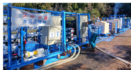
▲可搬式浄水施設（施設Ⅰ）の全景
