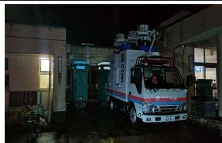
▲ 電源供給により停電を解消
