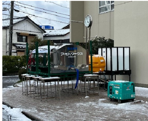
発動発電機（輪島市）
