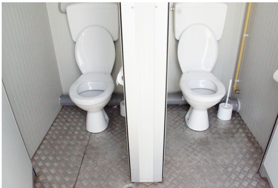
コンテナ製トイレ内部
