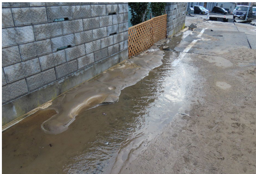
宅地・市道の液状化被害状況（新潟市）
