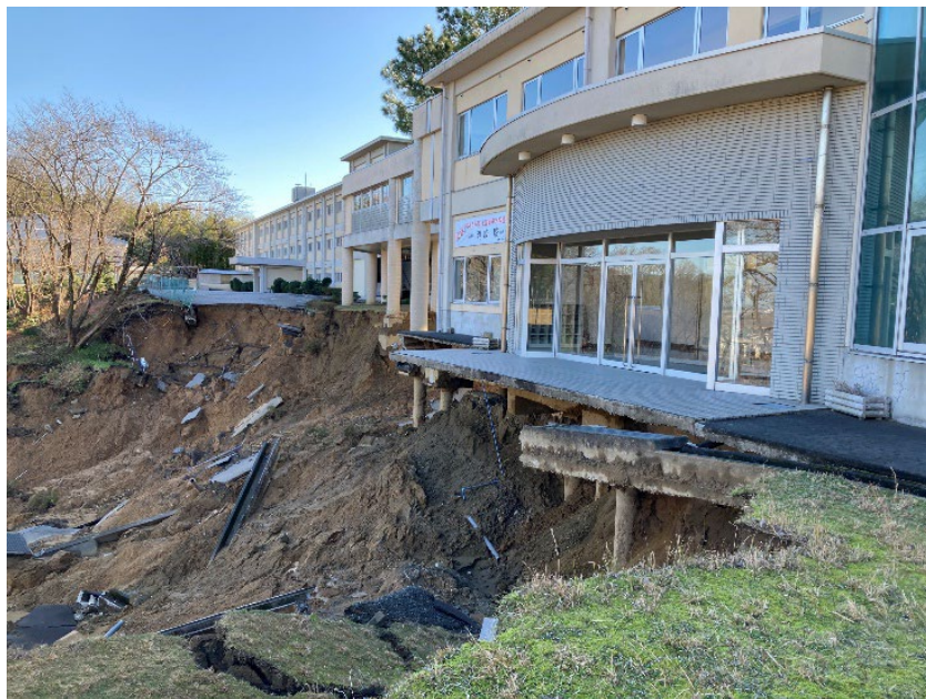
校舎前地盤が崩れ、地中杭が露出
