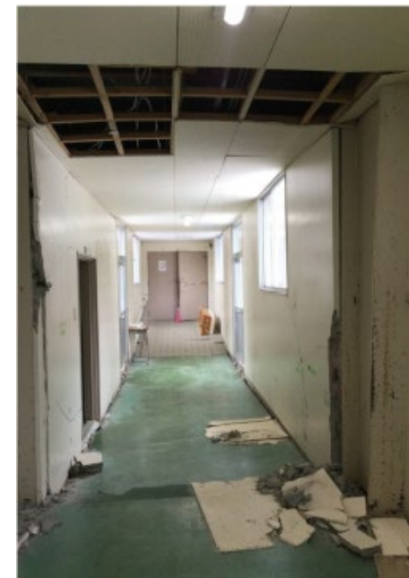
天井、内壁の落下
