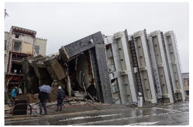
＜建築物の転倒被害＞
