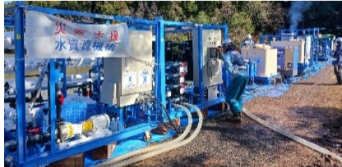
(独) 水資源機構保有の可搬式浄水施設 (珠洲市内の農業用ため池に設置時の様子)
