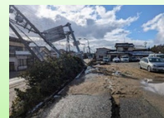
液状化被害の状況（石川県）
