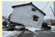
木造住宅の被害
