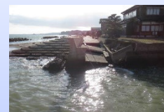
海岸堤防の護岸損壊（宝立正院海岸）
