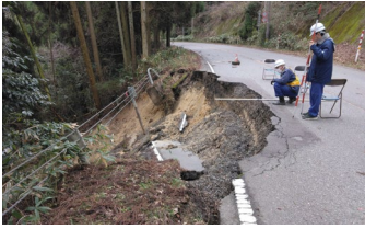
危険な箇所での被災状況調査 (石川県志賀町)
