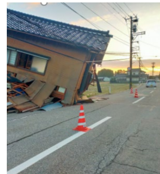
地域：石川県穴水町 家屋倒壊でCATV線・NTT線に寄り掛かっている状態
