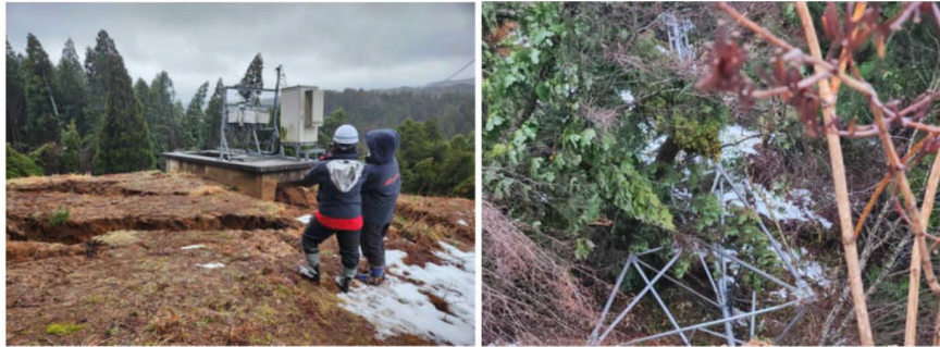
倒壊した基地局
