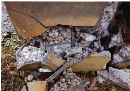
地域：石川県七尾市 中継局の局舎の基礎が損壊
