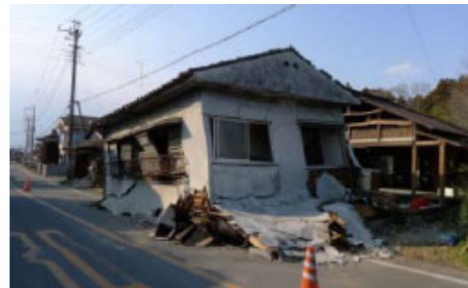
揺れによる被害
