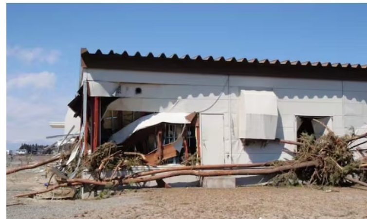
KDDIの海底ケーブル陸揚げ局は東日本大震災で倒壊した
