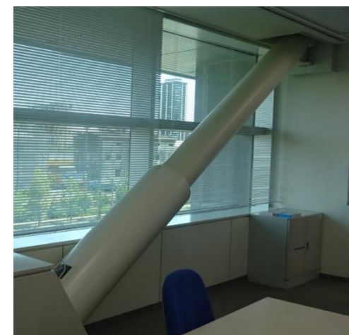
(制震オイルダンパー)
