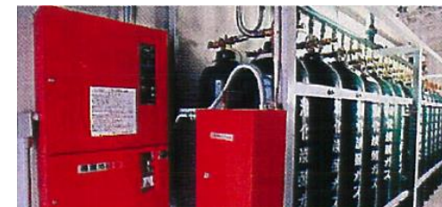
(不活性ガス消化設備)
