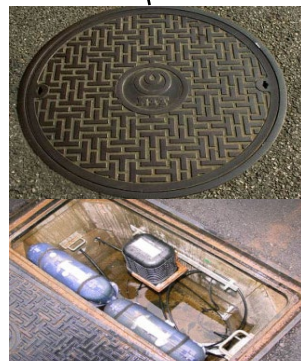
マンホール・ハンドホール
