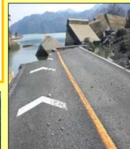
津波で被災した国道45号
