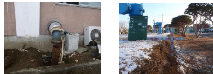
図3 宮城県水道施設の被災状況
