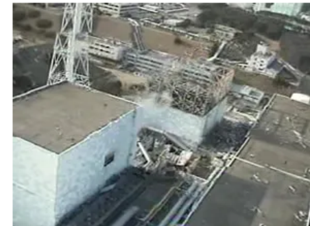
写真5. 福島第一原子力発電所1号機、2号機 一写真手前から2号機、1号機。左側が原子炉建屋、右側 がタービン建屋。 (平成23年4月10日撮影)
