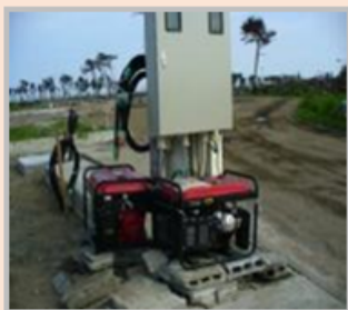
可搬型発電機
