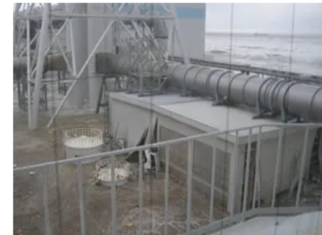
写真3. 福島第一原子力発電所 津波来襲状況 集中廃棄物処理建屋4階から北側を撮影 (平成23年3月11日撮影)
