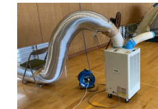
スポットクーラーの設置
