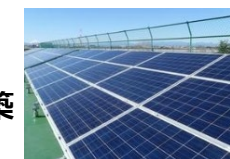
太陽光パネル
