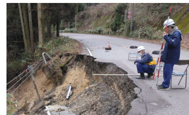
危険箇所での被災状況調査
