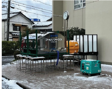
発電機（輪島市）
