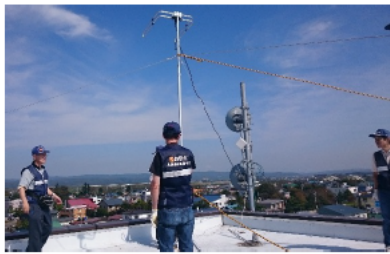
役場屋上に設置された臨時災害放送局のアンテナ
