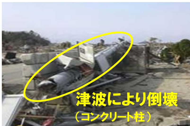
①基地局設備(宮城県 松島野蒜)
