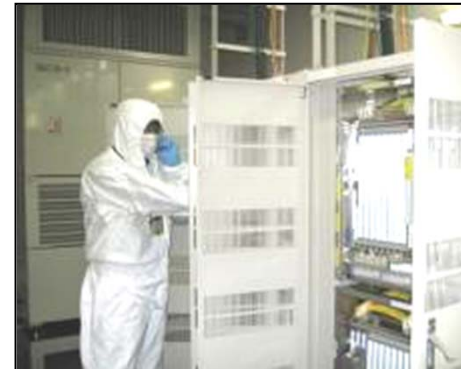
【4月13日】基地局伝送路の切替 (富岡町内の通信ビル)
