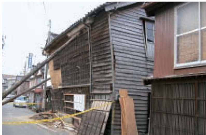
事業所(輪島漆器)の被害状況(輪島市)
