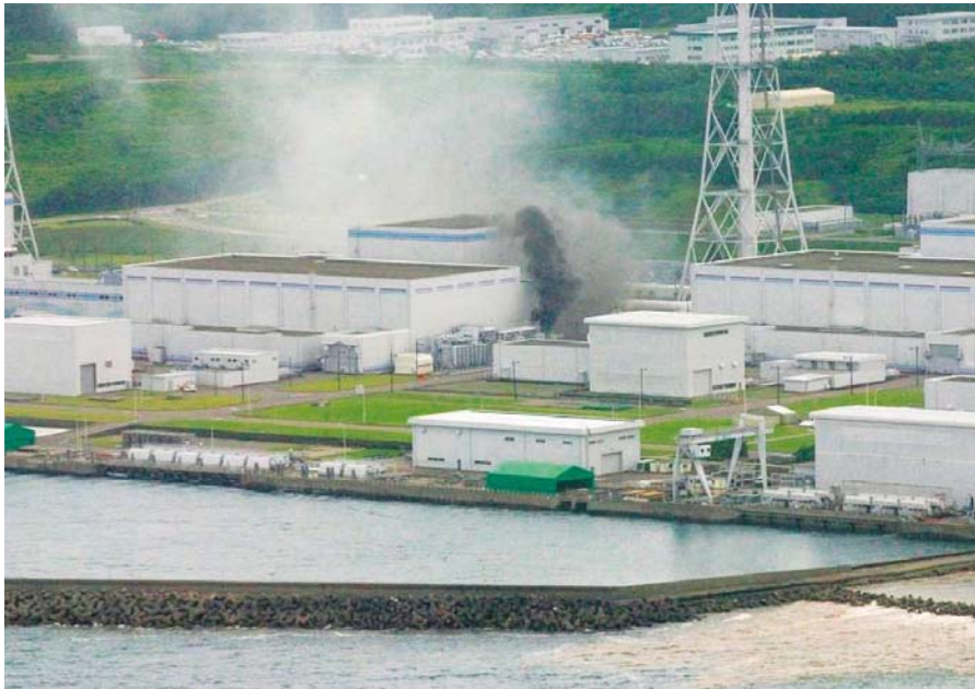
柏崎刈羽原子力発電所3号機所内変圧器の火災
