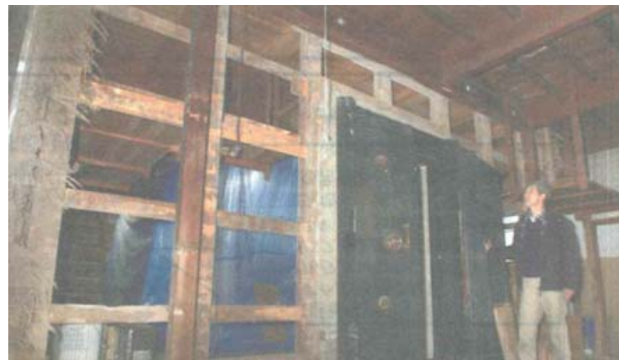
壁がはがれ落ちた漆器店の土蔵(輪島市)
