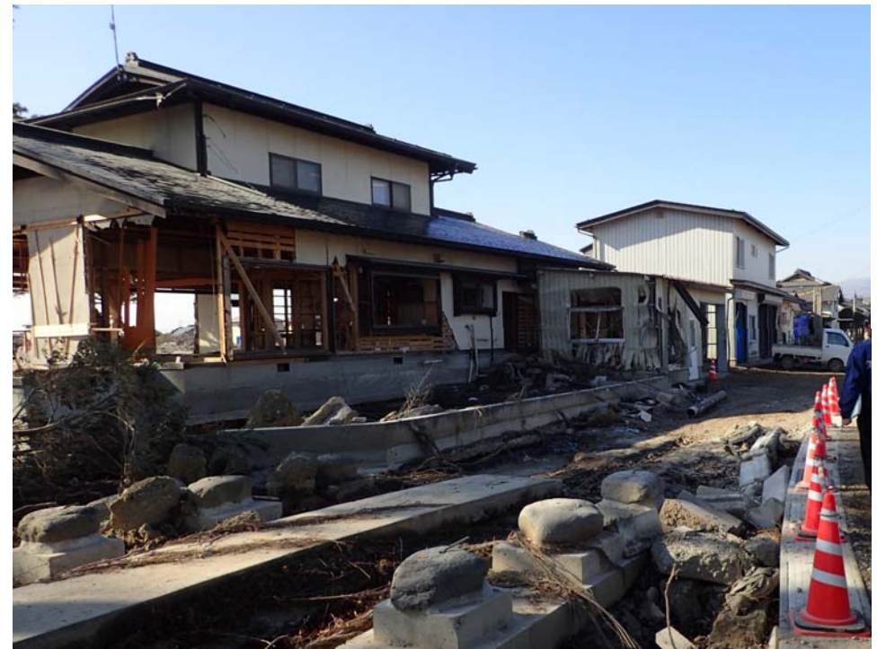
氾濫流による建物崩壊(長沼地区)
