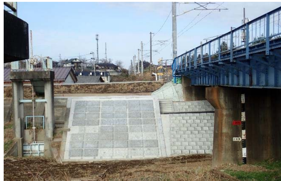
安達太良川の堤防天端崩壊(復旧後)
