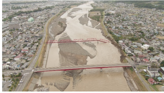
千曲川の堤防欠損、落橋の状況 (長野県上田市)
