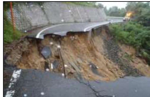
↑ 舞鶴宮津線（宮津市皆原）の路肩欠壊
