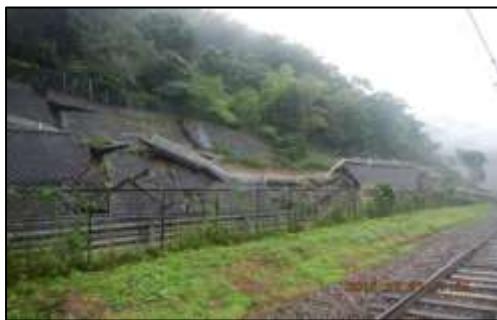
↑ 国道27号（舞鶴市真倉）の法面崩壊
