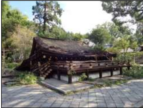
↑平野神社拝殿倒壊（府指定建造物）
