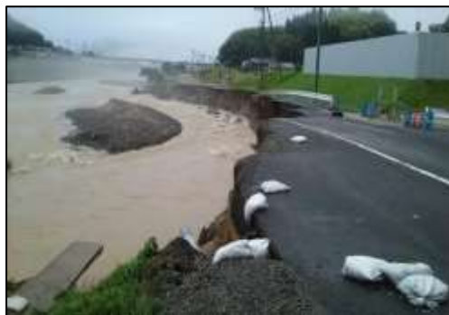
↑ 綾部大江宮津線（福知山市大江町関の路肩崩壊
