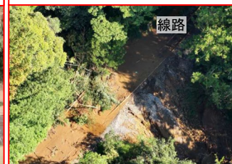
②久留里線・上総松丘～上総亀山間 盛土崩壊
