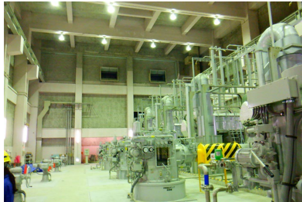
三階橋ポンプ所
