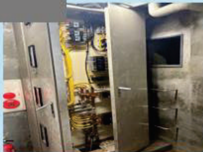
電気設備の浸水 8/13～
