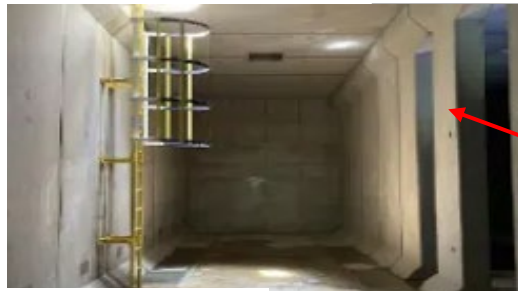
みつわ台雨水貯留槽 貯留量: 7,500m 3
