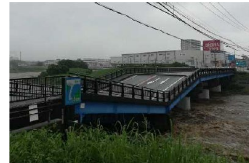
黄瀬川大橋の被害（静岡県沼津市）
