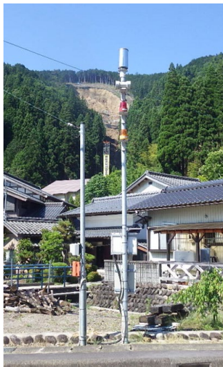
設置したサイレン
