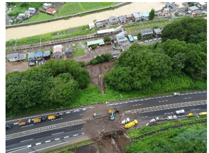
川岸東地区での土石流による被害 （長野県岡谷市）
