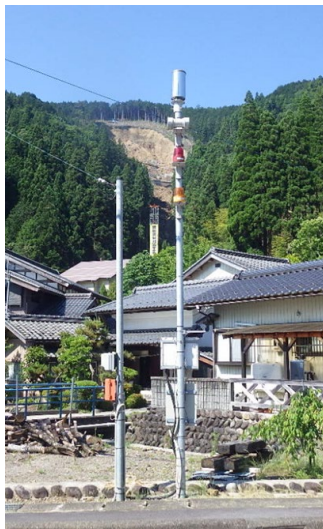
設置したサイレン
