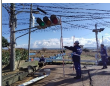
道路の被災状況調査 (石川県内灘町)
