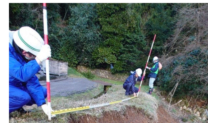
査定に向けた被災ため池の法面崩落の測量
