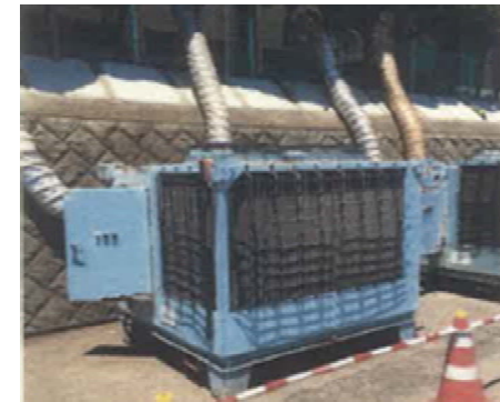
エアコン(室外機)
