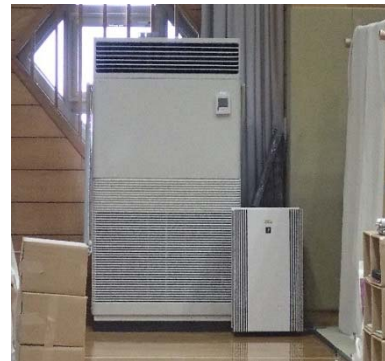
エアコン(室内機)
