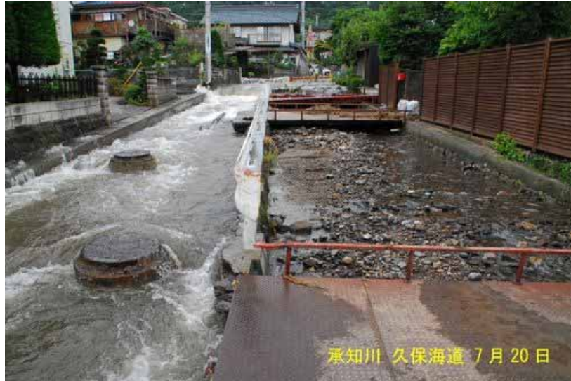
平成18年7月豪雨による被災状況（写真左が国道、右が承知川）
