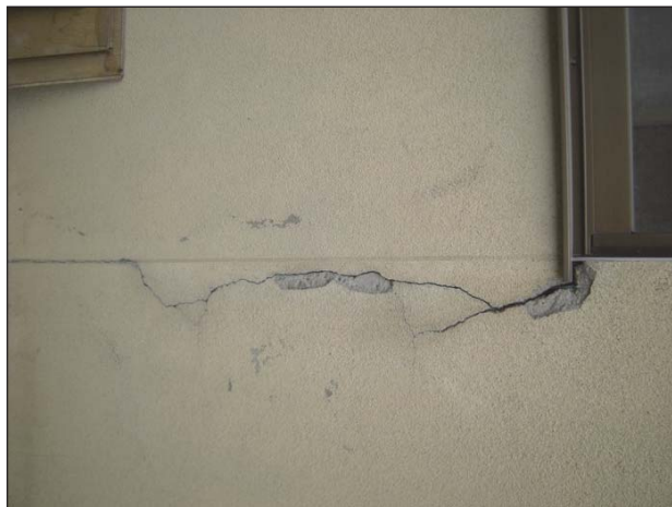
【仕上面】 塗り壁の開口部隅角部廻りにわずかなずれが生じている。
