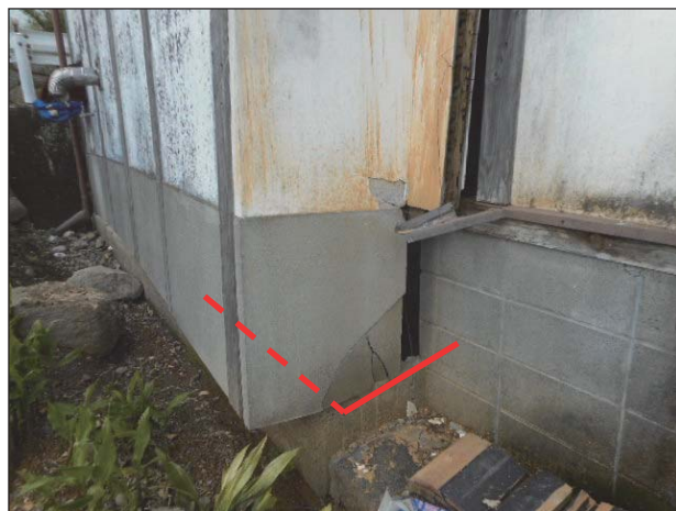
土台が基礎から著しくずれている。
