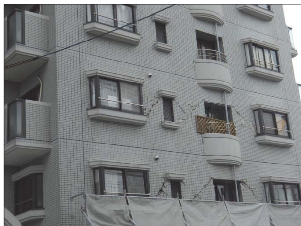
【外部仕上】 大きなひび割れ又は仕上の剥離が見られる。 50104
