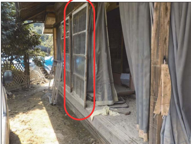
【木製サッシ】 破損し、開閉が困難になっている。
