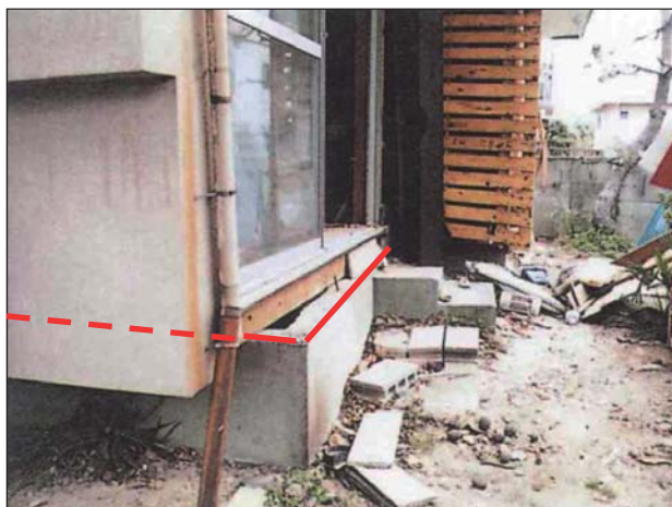
土台が基礎から著しくずれている。
