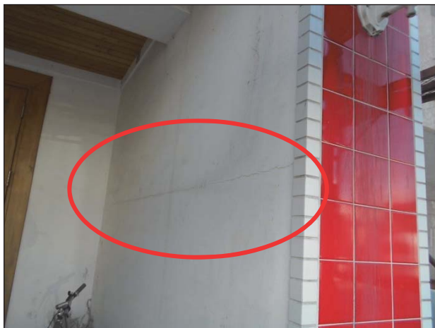
【外部仕上】 仕上げや仕上材の目地にわずかなひび割れ(幅約0.2mm)が見られる。 50095
