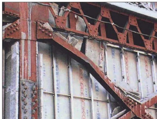
【鉄骨造】 座屈変形が見られる。
