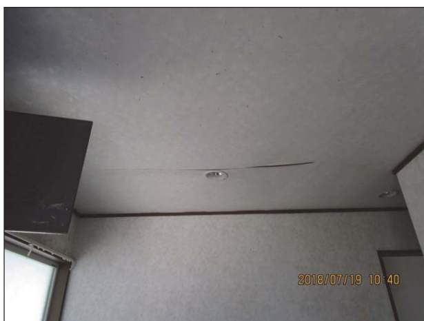
天井板に隙間が生じている。
