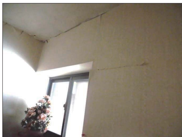
天井板に隙間が生じている。
