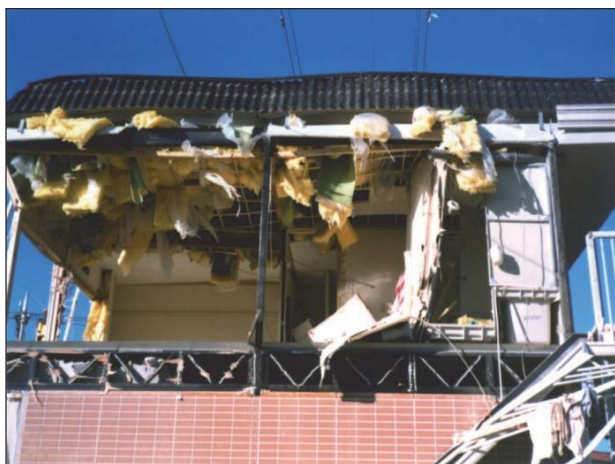
【パネル工法】 パネルが壁面から脱落している。
