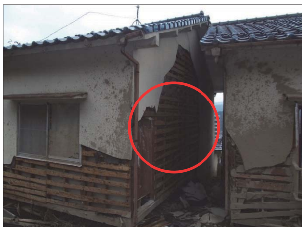
【仕上面】 塗り壁では仕上の大半が剥離又は脱落している。
