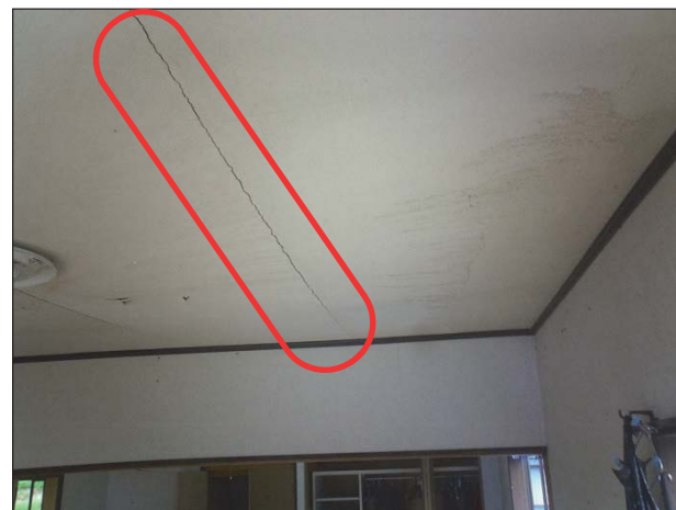
塗天井に亀裂が生じている。
