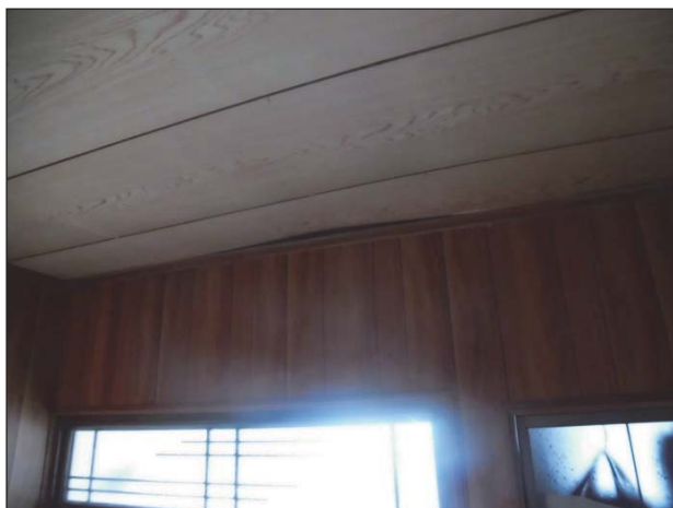
天井板の浮きが生じている。
