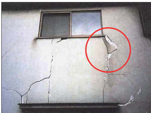
【仕上面】 塗り壁の各所で仕上の剥離が生じている。
