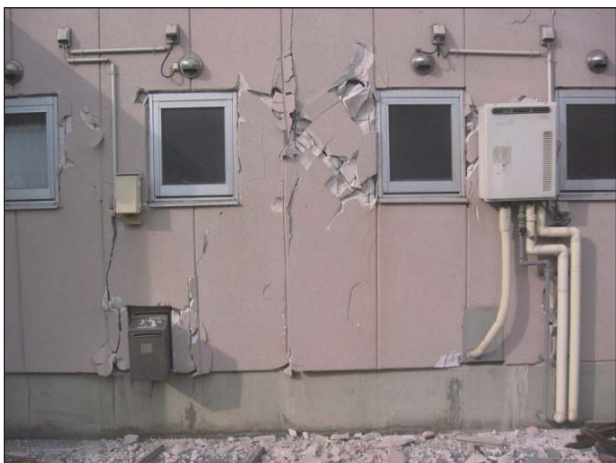
【外部仕上】 大きなひび割れ又は仕上の剥離が見られる。 50103
