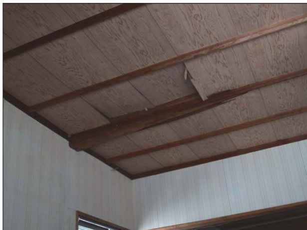
天井面に歪みが見られる。
