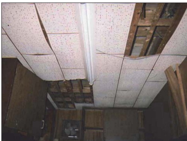
天井板が脱落している。
