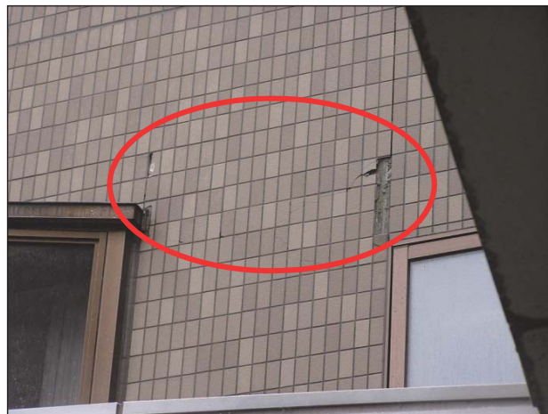
【外部仕上】 仕上材のわずかな剥離、目地のずれが見られる。 50096
