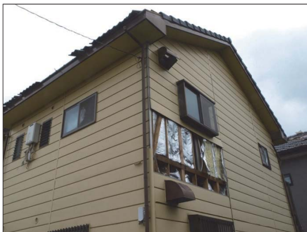
【仕上面】 ボード仕上の壁では大部分で釘の浮き上がりが見られ、中には脱落したものも見られる。
