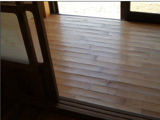
浸水によりフローリング材の層間剥離・浮き上がり、沈下が見られる。
