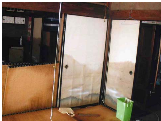
20095 【障子・襖】 浸水による襖・障子・ドアの破損(表面、格子・縁の洗浄、張り替えによって、再使用が可能な程度)
