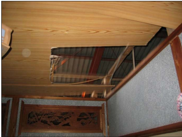
天井板のずれ、一部脱落が見られる。
