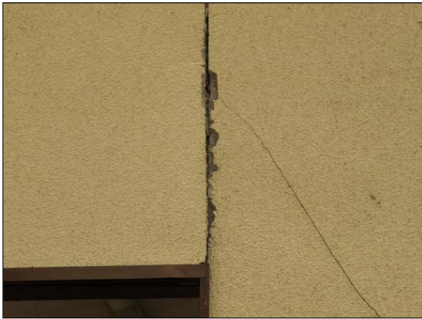
【仕上面】 目地にわずかなひび割れが生じている。
