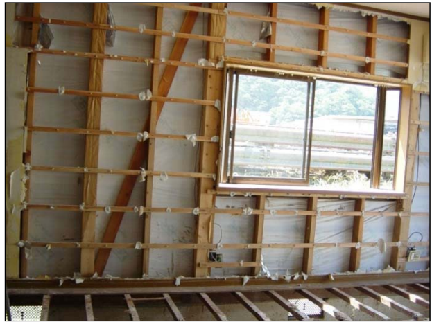
20076 浸水により断熱材の吸水による機能損失(再使用が不可能な程度)が見られるため、耐力壁の一部(ボード等)の取り外しが必要である。
