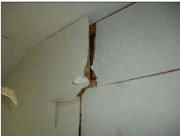
【枠組壁工法】 合板のはがれ、ずれが著しい。
