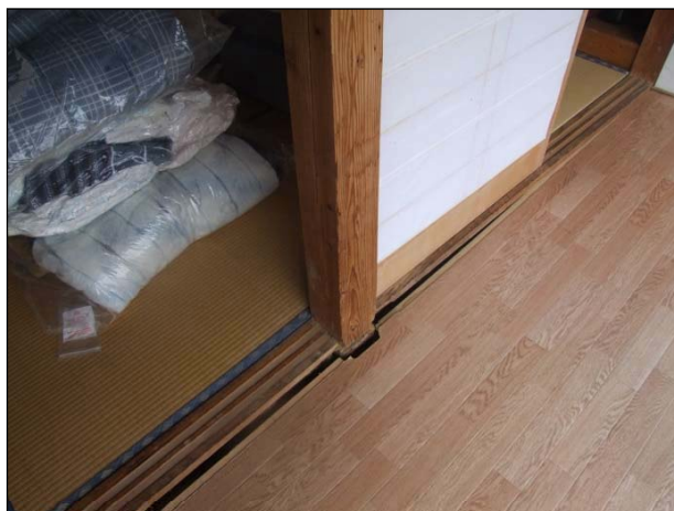
床板にずれ、若干の不陸が見られる。
