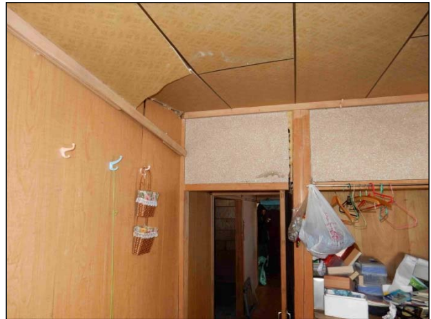
天井面の歪みが見られる。 天井板のずれ、一部脱落が見られる。
