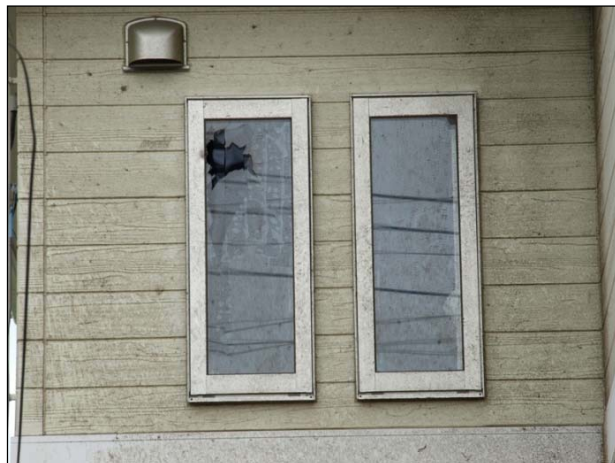
30042 【アルミサッシ】 ガラスが破損している。
