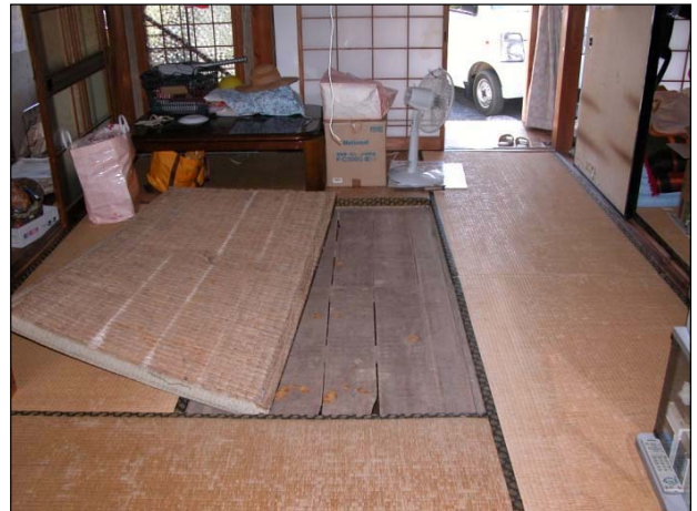
浸水により畳の吸水・膨張による機能損失が見られる。
