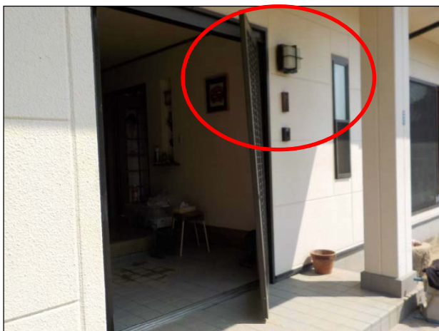
10148 【ドア】 蝶番に変形が見られ、取り付け部がはずれている。
