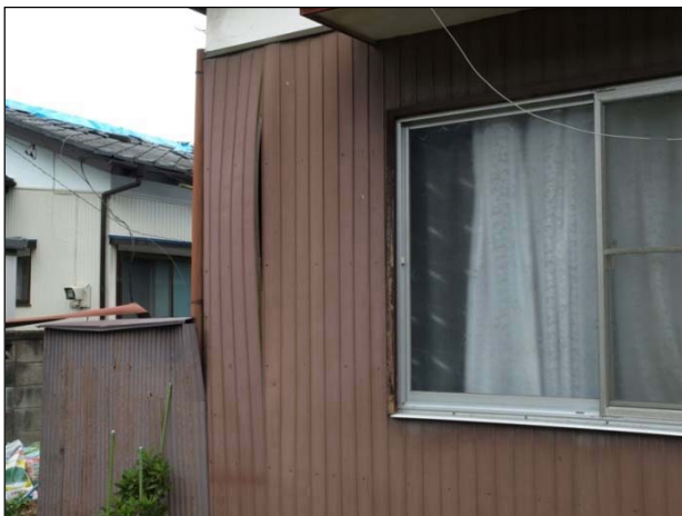
【仕上面】 ボード仕上の壁では一部のボードの仕上面の目地部にひび割れやずれが生じている。
