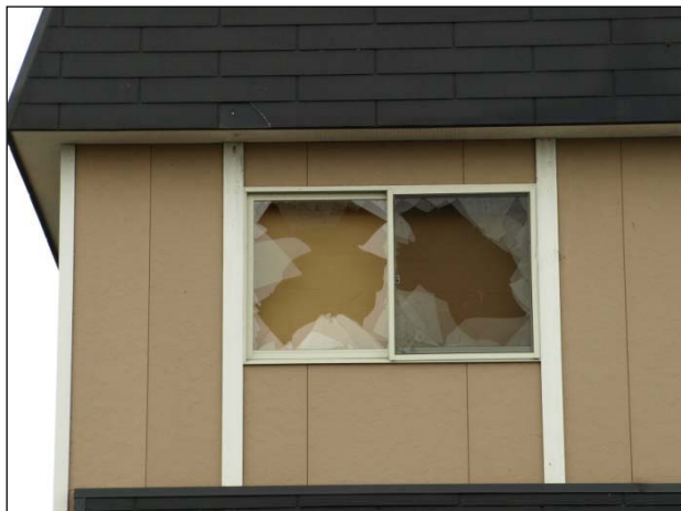
30041 【アルミサッシ】 ガラスが破損している。
