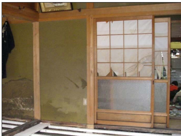
20094 【障子・襖】 浸水による襖・障子・ドアの破損(表面、格子・縁の洗浄、張り替えによって、再使用が可能な程度)
