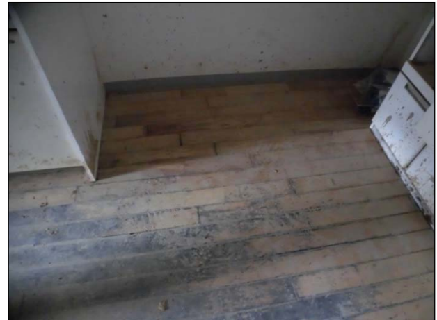
浸水により床板の汚損が見られる。
