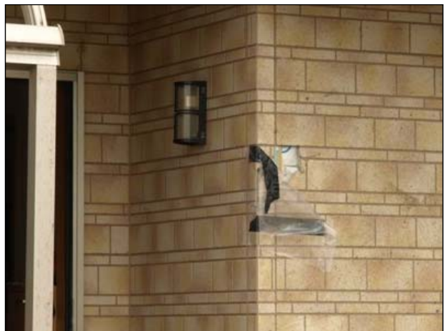
壁に飛来物の軽微な衝突痕がある。
