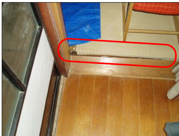
(床と敷居との間にわずかなずれが生じている。)
