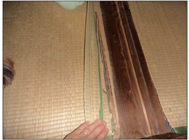
床仕上・畳に損傷が見られる。
