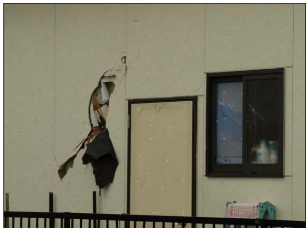
壁の一部に飛来物による突き刺さり、貫通痕がある。
