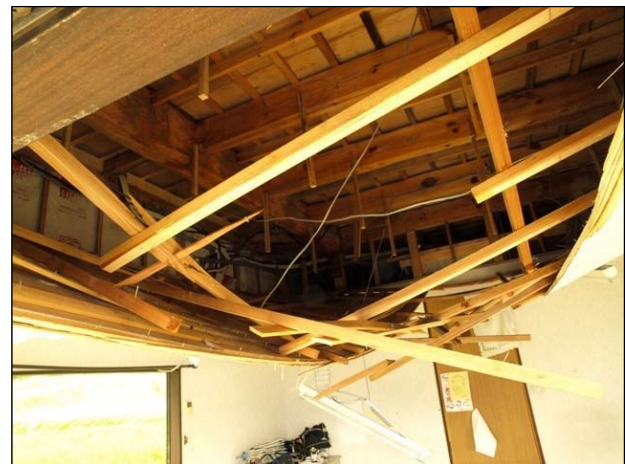
天井板が脱落している。
