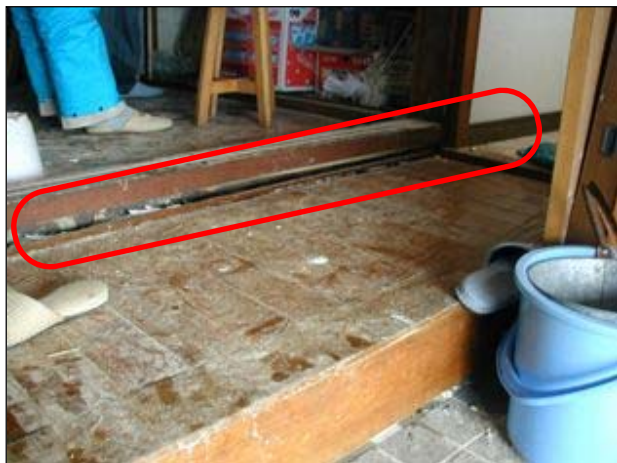
床板にずれ、若干の不陸が見られる。
