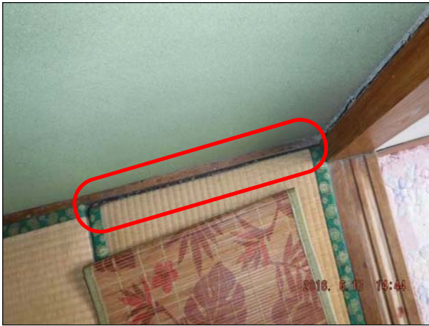
床と壁との間にわずかなずれが生じている。
