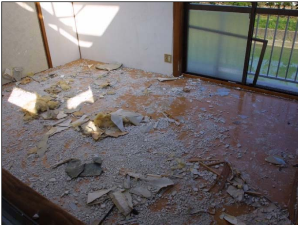
浸水により床板の汚損が見られる。
