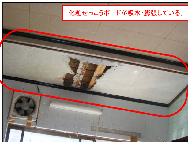
浸水による下地材・化粧せつこうボード・その他天井材の吸水・膨張・不陸等の機能損失が見られる。 (下地材・天井板の交換を要する程度)
