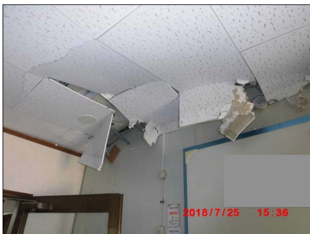
天井板が脱落している。
