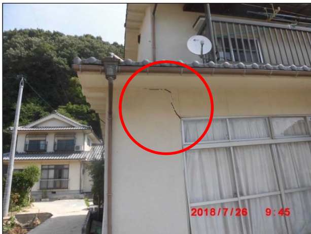
【モルタル塗り仕上等】 開口隅角部にわずかなひび割れが生じている。
