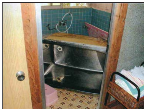
(浴槽：転倒し、配管が切れている。)
