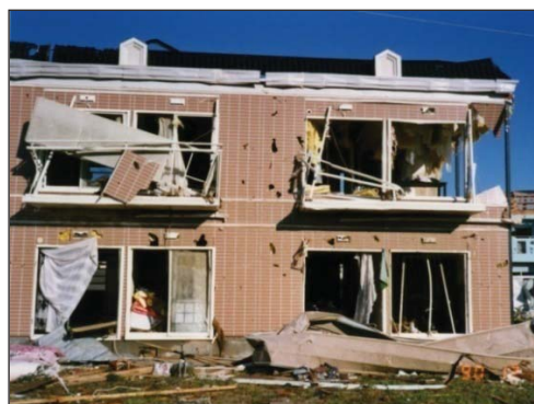
(ベランダ：手摺が破損している。)
