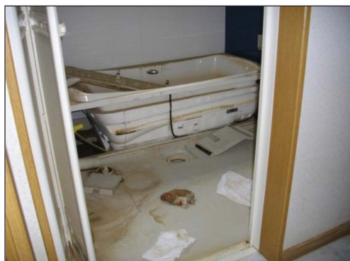
(浴槽：破損している。)
