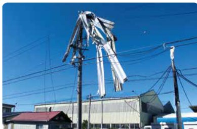
台風被害 飛来物による電線接触・断線
