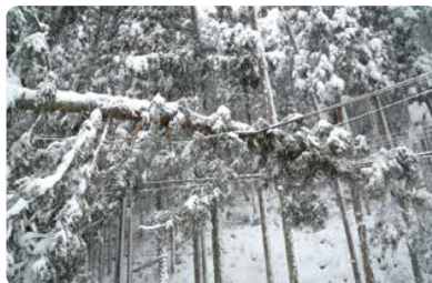
大雪被害 倒木による電線接触・断線
