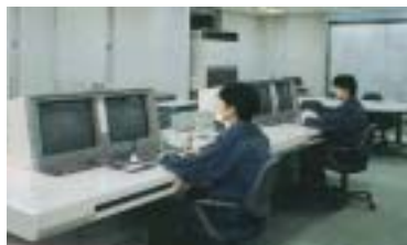
制御所(配電系統制御)
