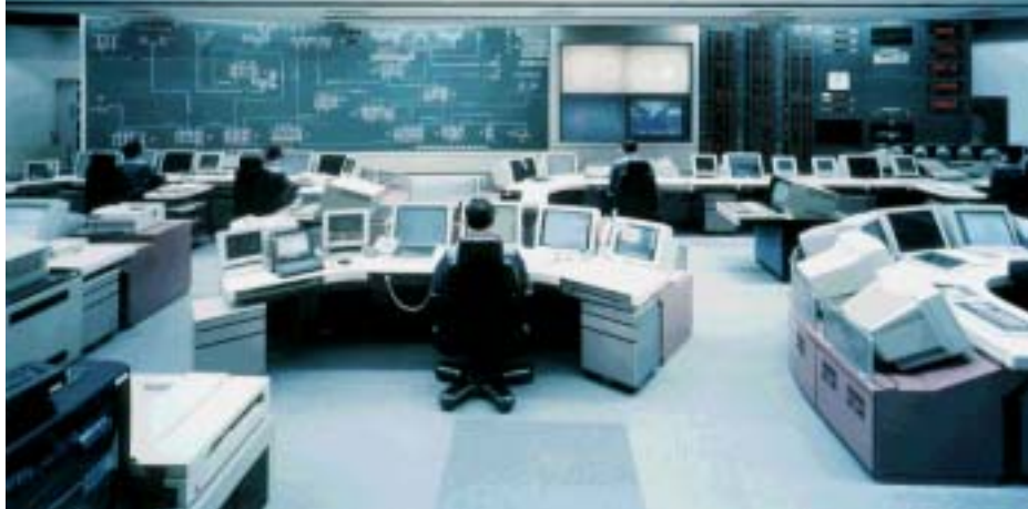
中央給電指令所における監視体制
