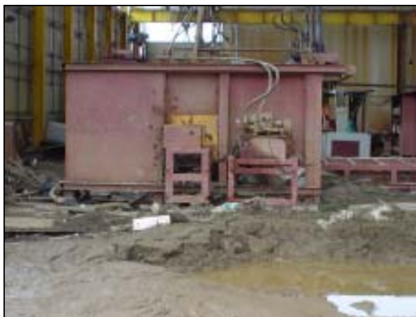
(写真) 被害を受けた A 工場の機械
