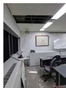
図 天井板の落下(工学院大学)
