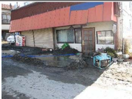
建物への被害(千葉県我孫子市)
