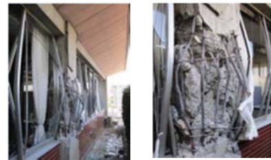
市役所本庁舎の被災状況
