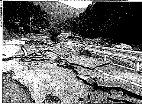
生活道路が寸断され孤立した集落も (宍粟市内)
