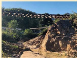
三陸鉄道 道床の流失
