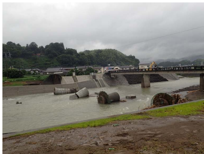
災害現場視察 【鉄道橋落橋現場】
