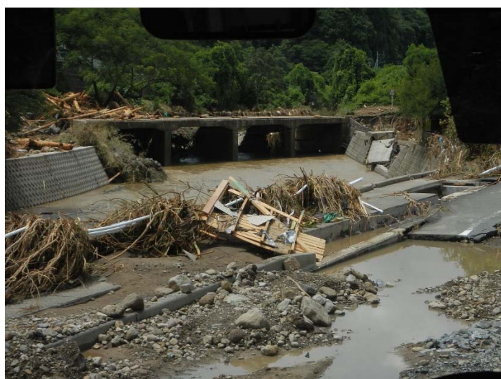
被災現場視察（車中から） 【大肥川】
