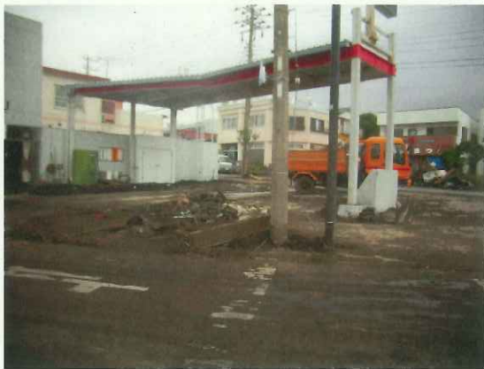
⑮給油施設が破損したガソリンスタンドの様子 【元町2丁目】
