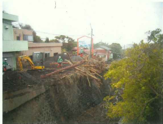
⑯土砂や瓦礫を撤去中の河川周辺 【元町2丁目】
