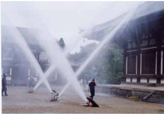
写真 - 1.5.2 散水設備の散水状況
