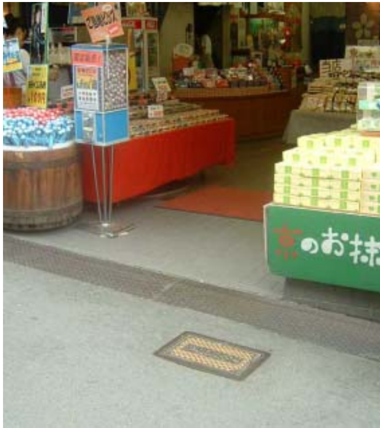
清水坂の消火栓
