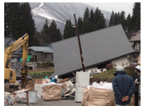
被災地における倒壊した家屋
