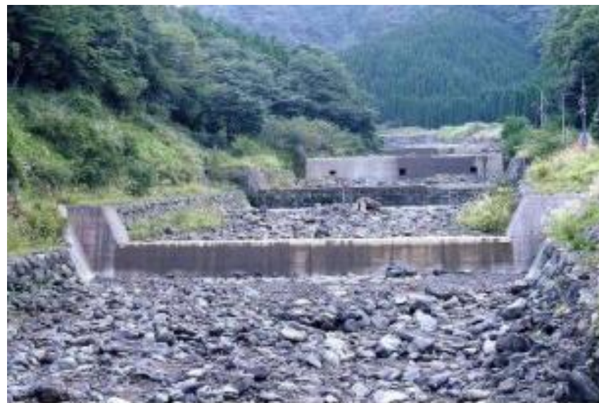
床固工群（霧島山）
