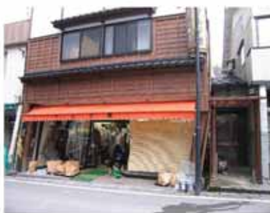
修復前（全壊判定）
