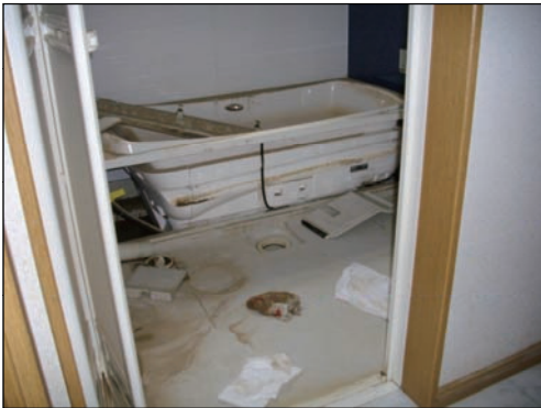
(浴槽：破損している。)
