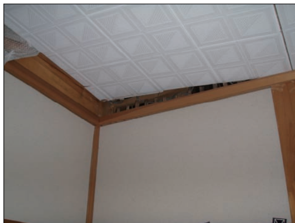
【天井】 天井板の浮きが生じている。 9506
