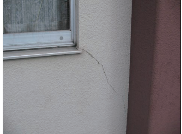
【鉄筋コンクリート造】 8302 近寄らないと見えにくい程度のひび割れ(幅約0.2mm以下)が生じている。
