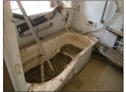
(泥流により使用できなくなった浴室) 5303
