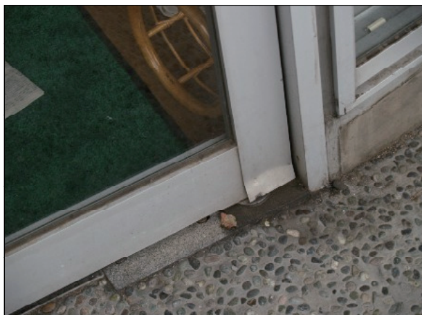
【ドア】 9703 変形が見られ、取り付け部がはずれている。
