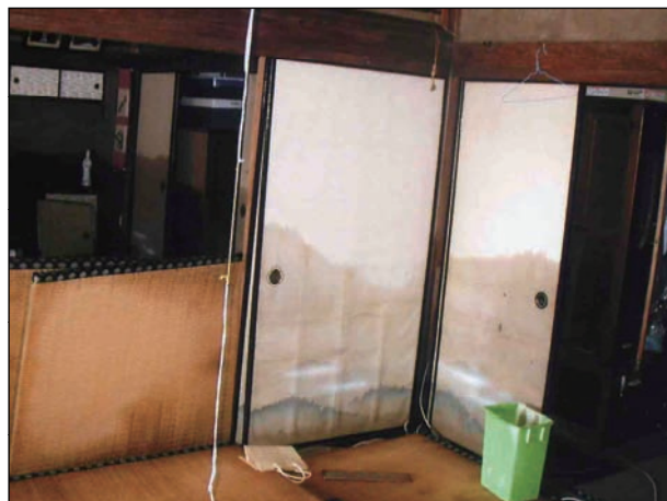
4902 【障子・襖】 浸水による襖・障子・ドアの破損(表面、格子・縁の洗浄、張り替えによって、再使用が可能な程度)
