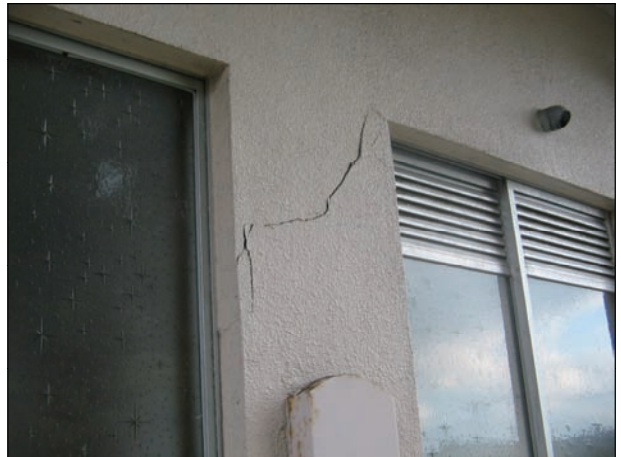
【鉄筋コンクリート造】 8304 肉眼ではっきりと見える程度のひび割れ(幅約0.2mm~1mm)が生じているものの、コンクリートの剥落は生じていない。
