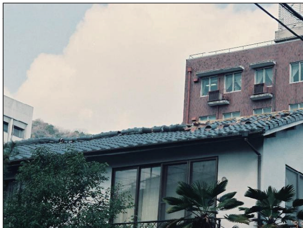
1505 棟瓦が全面的にずれ、破損あるいは落下している。
