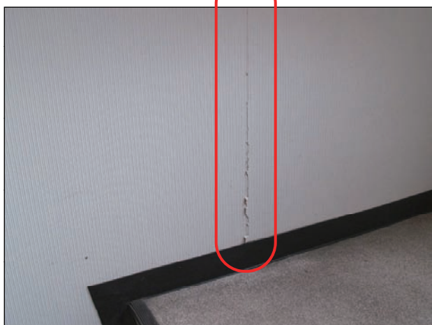
【内部仕上】 ボードの目地部にひび割れやずれが生じている。 9503
