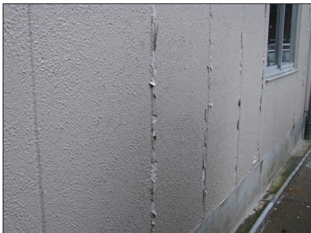
【外部仕上】 9303 仕上やパネルの目地にはっきりとしたひび割れが見られる。仕上材が部分的に剥離している。
