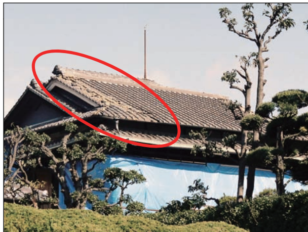
1506 棟瓦以外の瓦もずれが著しい。
