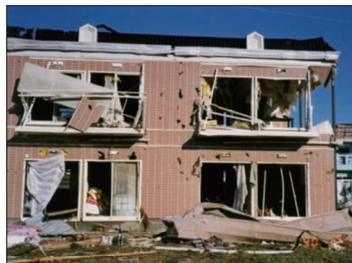
(ベランダ：手摺が破損している。)
