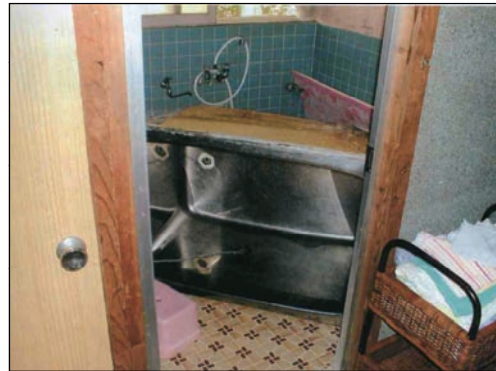
(浴槽：転倒し、配管が切れている。)
