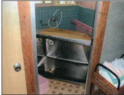
(浴槽：転倒し、配管が切れている。) 5302
