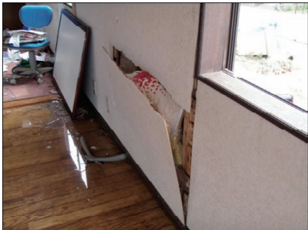
【内部仕上】 9601 内壁合板に剥離、脱落が見られる。
