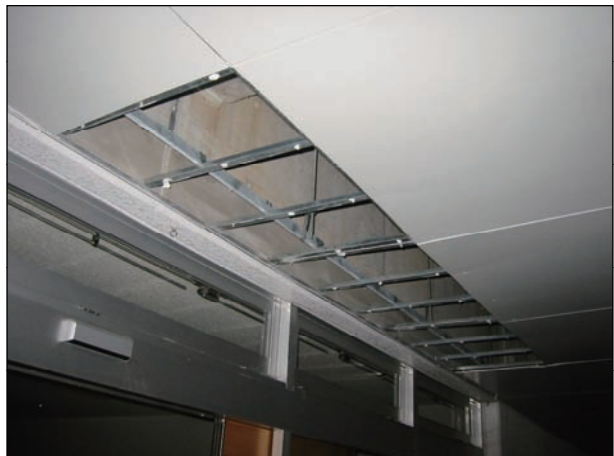
【天井】 9604 天井板が脱落している。
