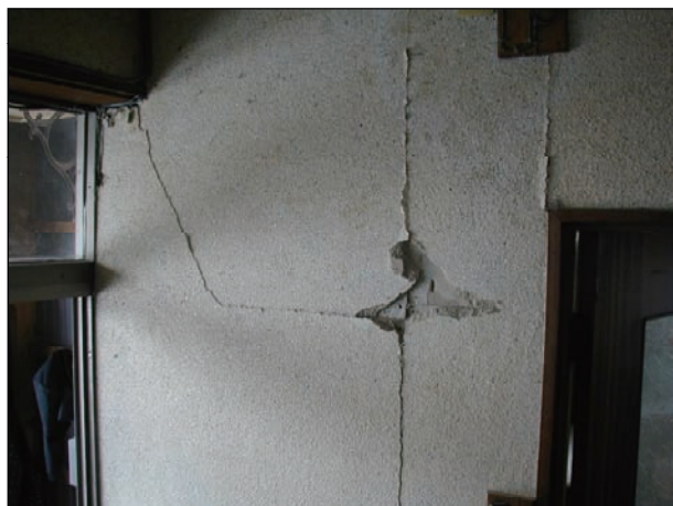
【内部仕上】 クロスが破れている。 9505
