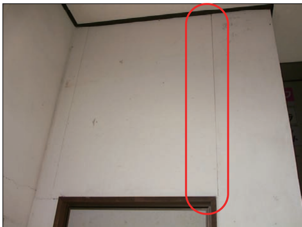
【内部仕上】 ボードの目地部にわずかなずれが生じている。 9501
