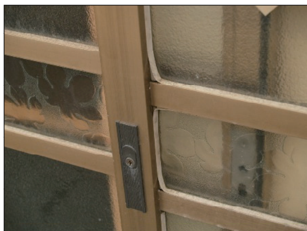
4904 【アルミサッシ】 鍵の破損や、ビードのはずれが見られる。
