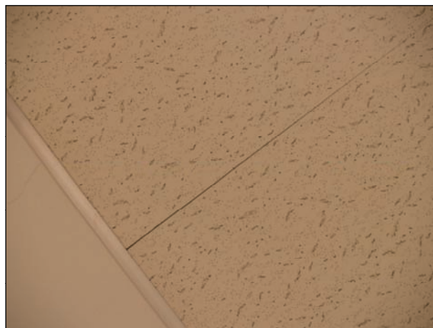
【天井】 天井板にわずかな隙間が生じている。 9502
