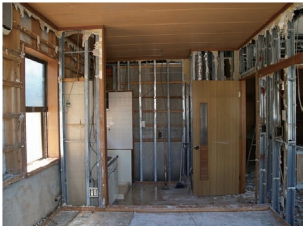
【内部仕上】 9603 浸水により下地材、パネルの吸水、膨張、不陸が見られる。
