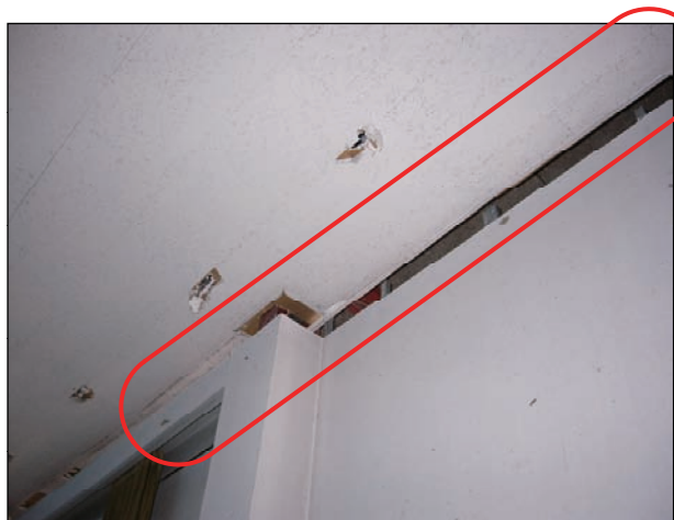
【天井】 9602 天井板のずれが見られる。
