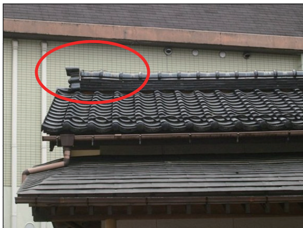
1501 棟瓦(がんぶり瓦、のし瓦)の一部がずれ、破損が生じている。
