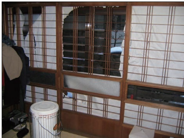
【襖・障子】 9701 家具の倒れ込み等によって襖紙、障子紙が破損し、張り替えが必要である。
