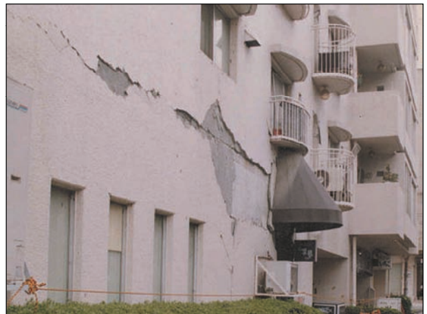
【鉄筋コンクリート造】 8306 比較的大きなひび割れ(幅約1mm~2mm)が生じているが、コンクリートの剥落は極くわずかで、鉄筋は露出してない。
