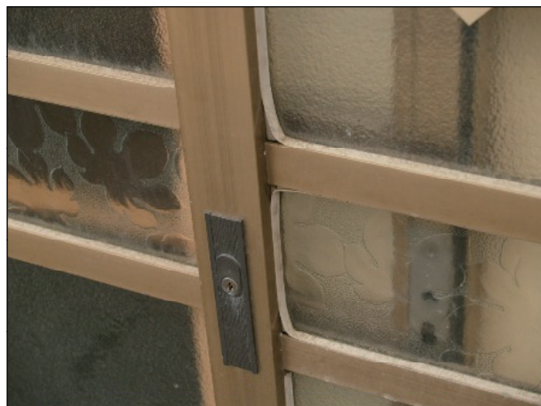
【アルミサッシ】 9704 鍵の破損や、ビードのはずれが見られる。あるいは開閉が不能になっている。
