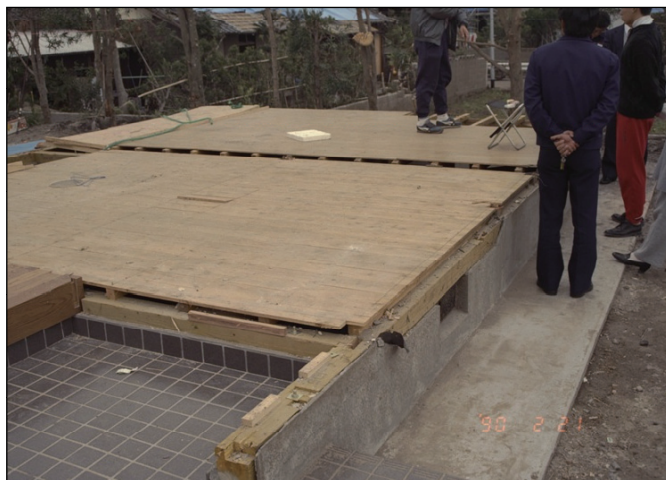
屋根や外壁、床が吹き飛ばされ、床下地、土台などが残る。基礎に被害は見られない。 5701
