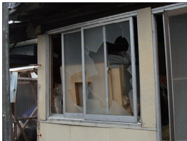
4906 【アルミサッシ】 ガラスが破損している。
