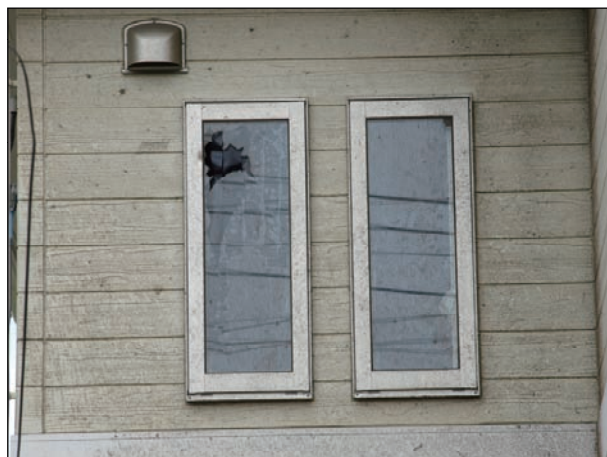
【アルミサッシ】 9706 ガラスが破損している。
