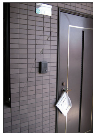
【雑壁】 9304 各所にひび割れ(幅約0.2mm~1mm)やはがれが生じている。
