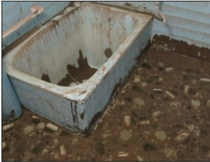
(浴槽：汚損し、配管が詰まっている。) 5301
