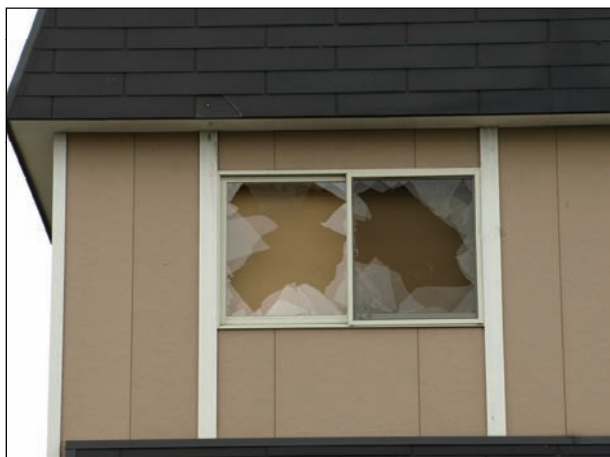
【アルミサッシ】 9705 ガラスが破損している。
