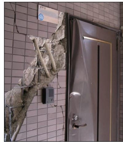
【雑壁】 9404 全体が変形し、仕上の大部分が剥落している。
