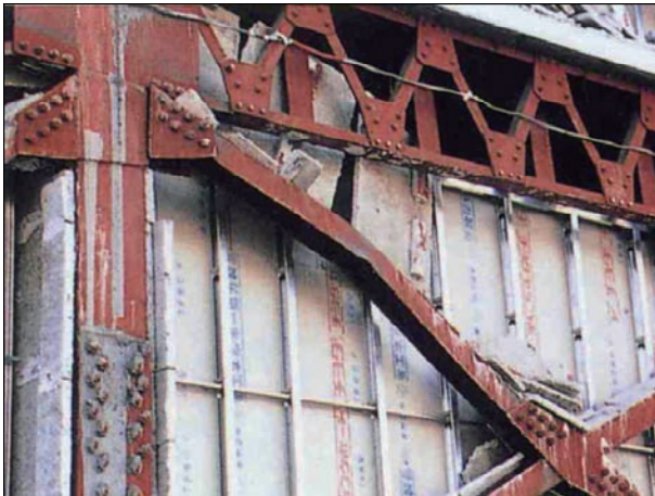
【鉄骨造】 8303 座屈変形が見られる。
