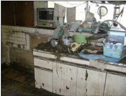
(台所の流し台：汚損し、配管が詰まっている。) 5304
