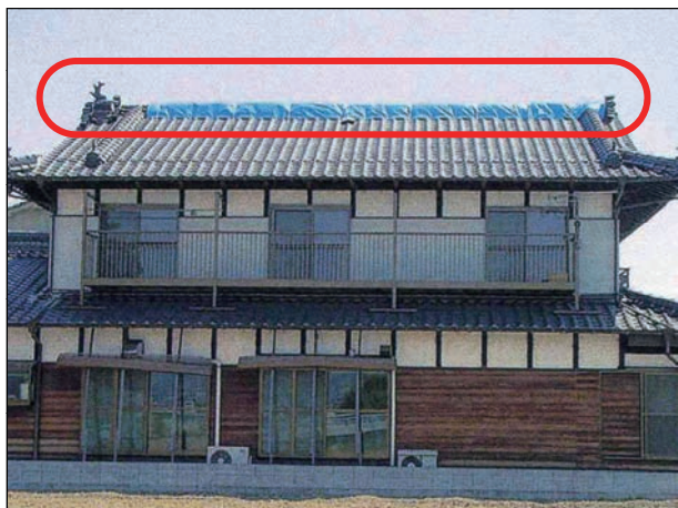
1503 棟瓦のずれ、破損、落下が著しいが、その他の瓦の破損は少ない。
