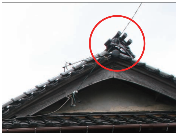
1502 棟瓦(がんぶり瓦、のし瓦)の一部がずれ、破損が生じている。
